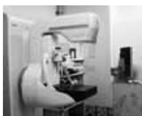
第3撮影室 (乳房撮影装置; 富士フィルム社)
